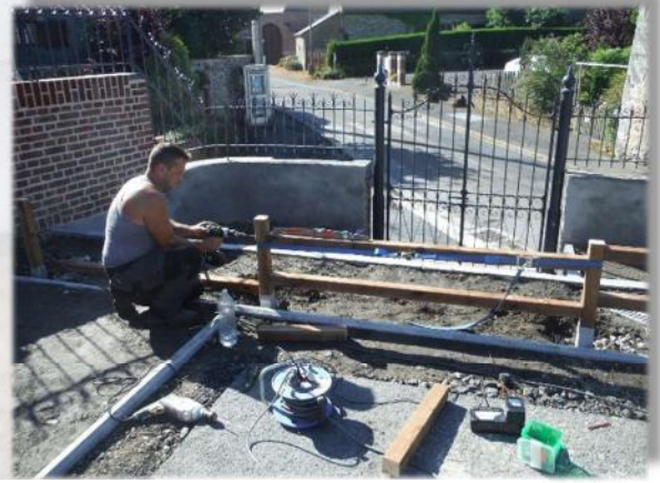
Les plantations, les couvre-murs, les raccords de macadam dans la cour, la fabrication et la fixation d'une barrière de sécurité et diverses finitions clôturent le chantier de l'école pour une dépense totale de 18.681 €.
